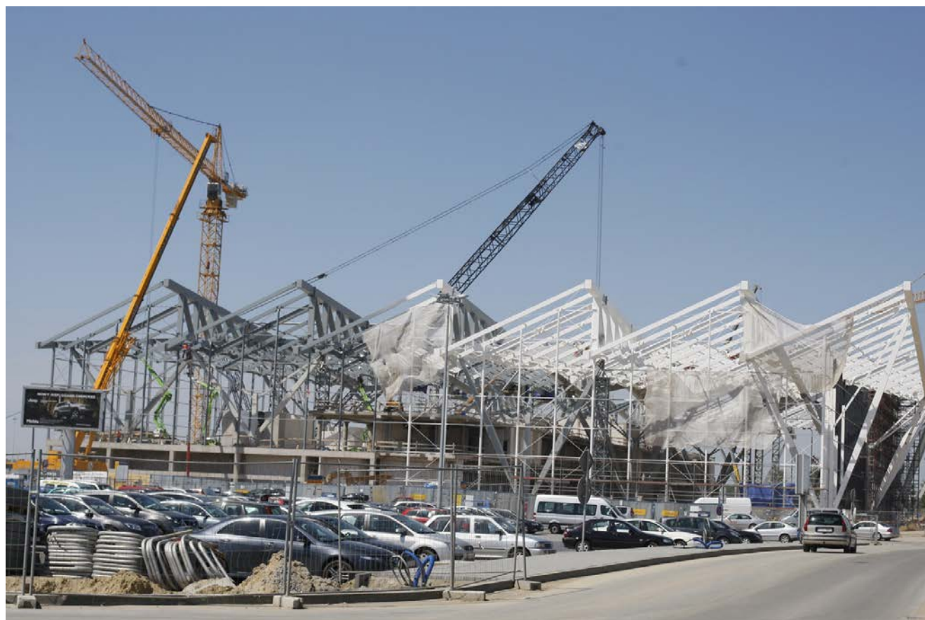
▲ Tak wyglądała budowa nowego Terminalu nr 2 w Porcie Lotniczym Gdańsk im. Lecha Wałęsy w 2011 roku
